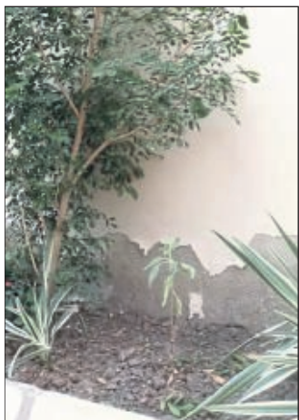
Die feuchte und salzhaltige Meeresluft lässt die Farbe am Haussockel abbröckeln.
